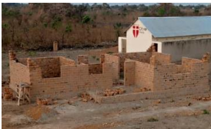
Mit einfachen Mitteln und selbst gebrannten Ziegeln wird unter Anleitung eines Baumeisters das Haus gebaut.
